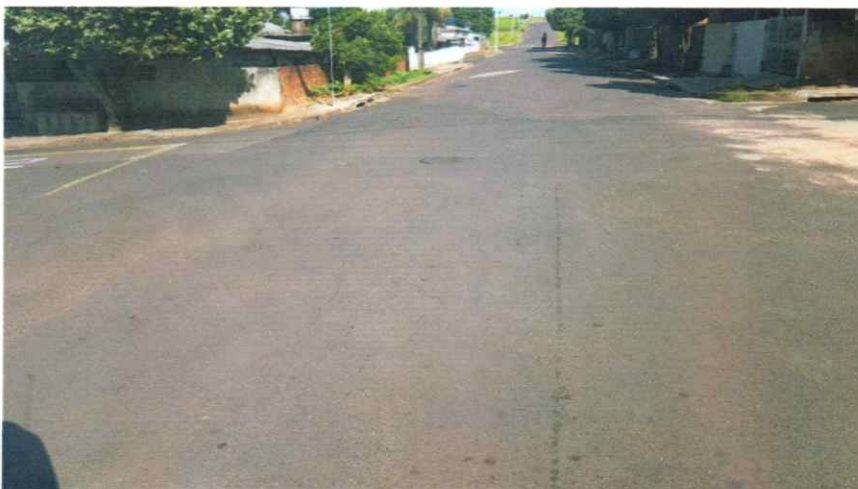
14 – RUA BENJAMIM CONSTANT: trecho do cruzamento da Rua Sely Francisco Rocha com a Rua Benjamin Constant.
